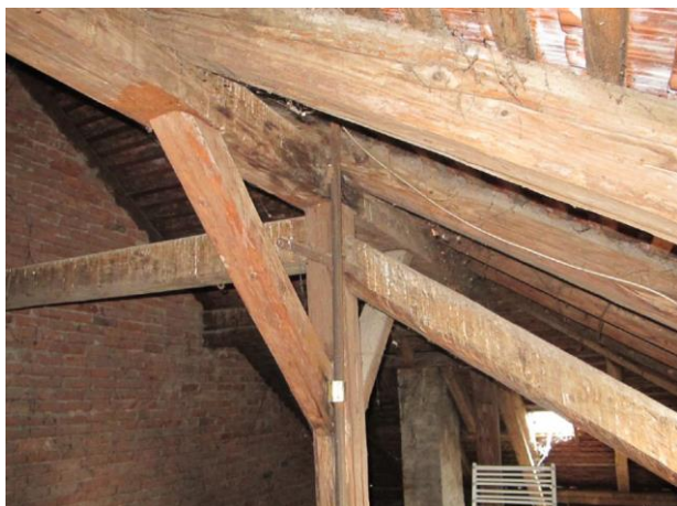
Slika 7 Stanje potkrovlja objekta u Zvonimirovoj ulici - Zagreb
