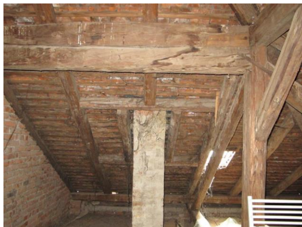
Slika 8 Stanje potkrovlja objekta u Zvonimirovoj ulici - Zagreb
